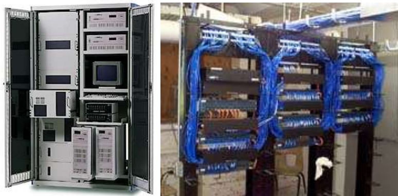
Racks o gabinetes de telecomunicaciones
